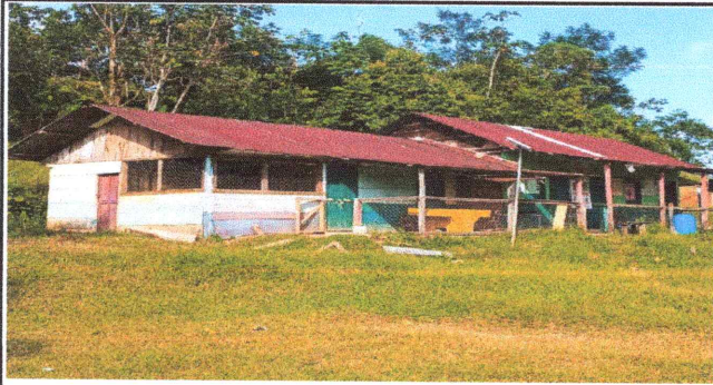
Foto1: laminas en mal estado y deteriorado
